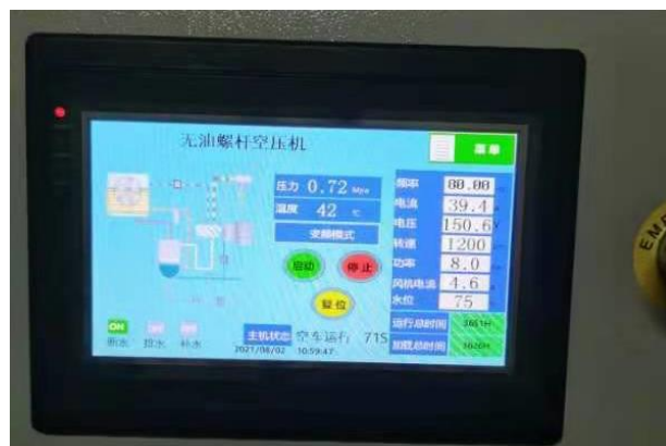
節能螺桿空氣壓縮機的操作介面
